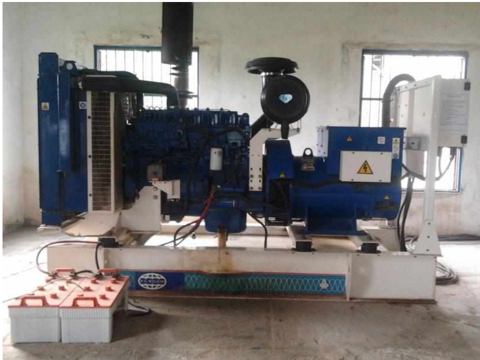
Hình 9.1: Máy phát điện F.G.WINSON
