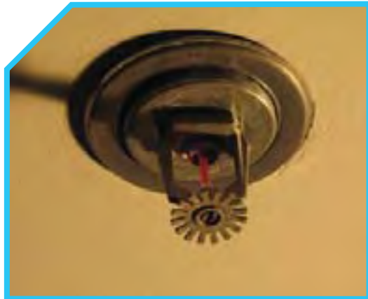
HỆ THỐNG VÒI PHUN NƯỚC
