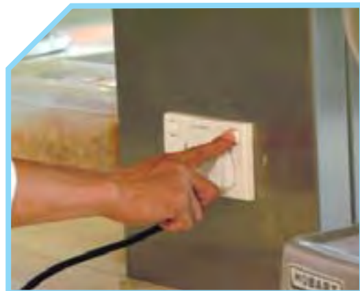
ĐẢM BẢO CÔNG TẮC ĐIỆN VÀ DÂY ĐIỆN AN TOÀN 11
