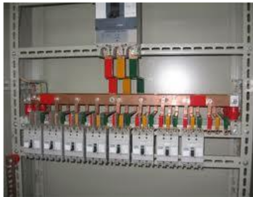
Hình 2.10. Tủ điện phân phối.
