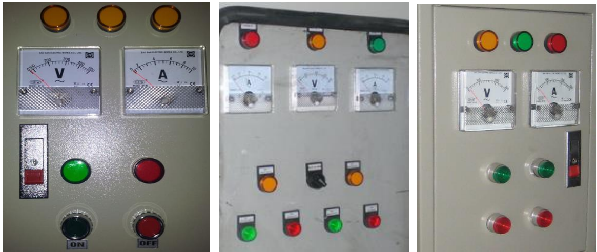
Hình 4.6. Vị trí vôn kế trên tủ điện
