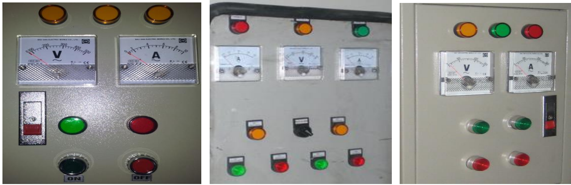
Hình 4.28. Vị trí Ampe kế trên tủ điện
